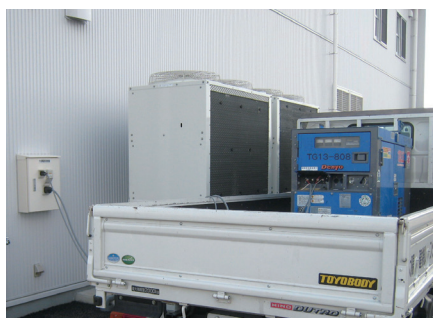
非常用切替設備を採用
