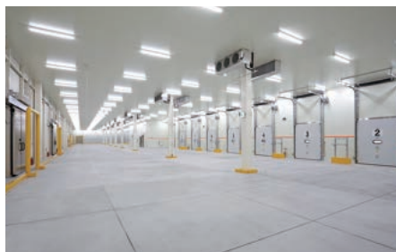
【冷蔵前室】ドッグシェルターから運び込まれた荷物は、この5℃に保たれた前室を通過して冷凍倉庫へ運ばれます。
