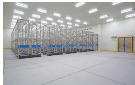
【冷凍倉庫とラック】前室の奥の-25℃の部屋です。結露が生じないように、入念に結露対策が講じられています。
